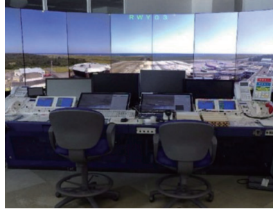
写真1 遠隔地側の装置
