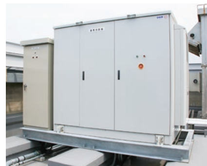
東京建物博多ビルへの蓄電池設置
