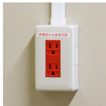
「赤コンセント」 (非常用回路につながる専用コンセント)
