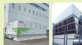
新たに設置されたヒートポンプ式の熱源機器(左は外観)
