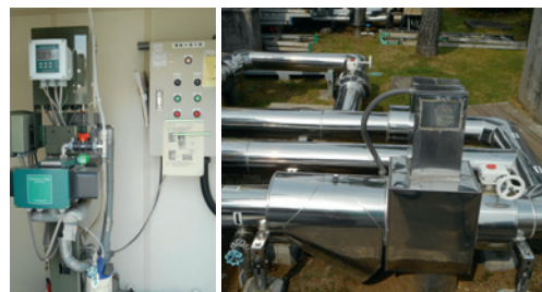
水質センサー(左)と自動切換え弁付きの配管を組み合わせることで水質を確保しながら井戸水の使用を削減
