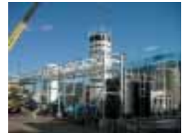
半導体生産拠点の排水処理・リサイクル装置
