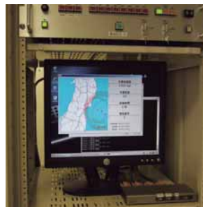
宮城沖電気(株)に設置された「リアルタイム地震防災システム」
