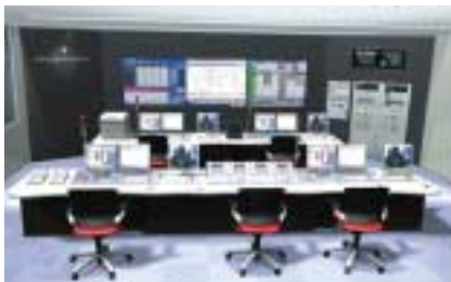
消防指令管制システム
