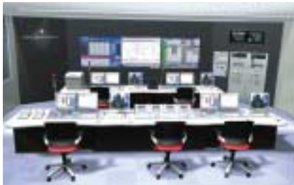
消防指令管制システム
