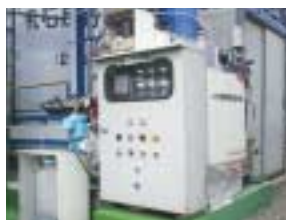
廃液処理装置
