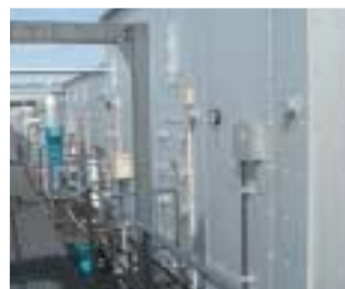
高速エアワッシャ空気調和機の外観
