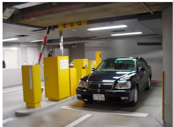
写真1 契約車両駐車場システム・入場口
