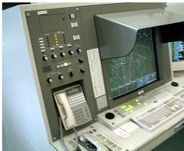
写真2 レーダ運用卓外観
