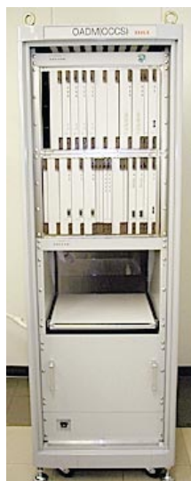
写真1 実験装置の外観 Photo 1 Test-bed system
