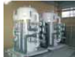
半導体製造で使用する超純水製造装置
