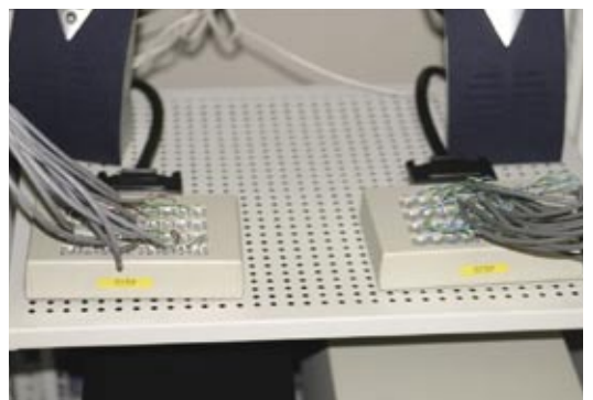
日本側サーバーとリンクする回線
