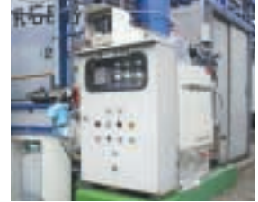
高速バイオ法新廃液浄化システム
