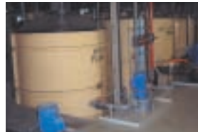
排水処理場に設置されたバイオリサイクルシステム
