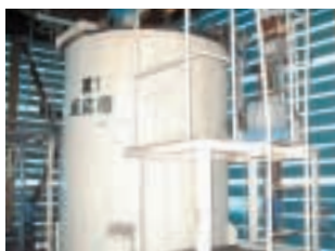
酸性廃液処理設備
