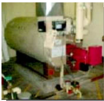
重油ボイラー 旧
