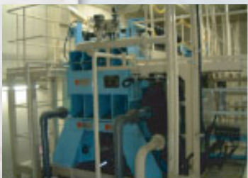
脱水処理施設
