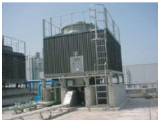
フリークーリング導入のため、増設したクーリングタワー
