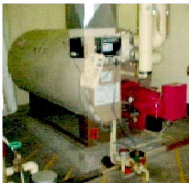
重油ボイラー〈旧〉
