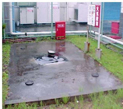
重油地下タンク〈旧〉（5,000ℓ）
