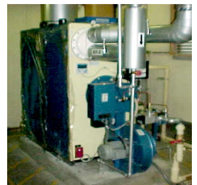
天然ガスボイラー〈新設〉
