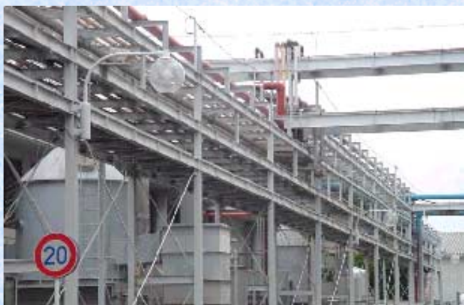
配管架台群(地上配管)
