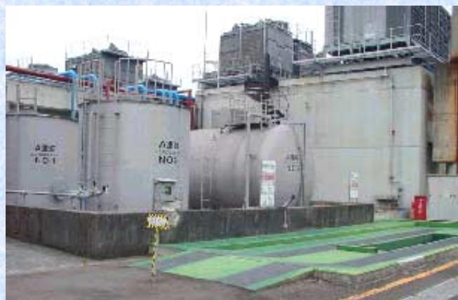
重油タンク・ローリー受入防油堤
