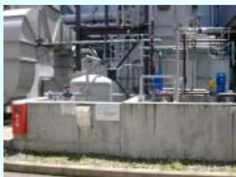
↑薬品タンクと坊液堤
